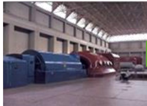
Sala macchine prima dello smantellamento
