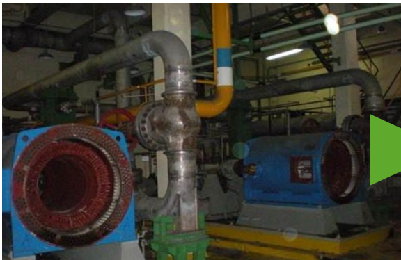
Locale scambiatori prima dello smantellamento
