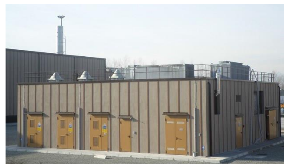
Nuova Cabina Elettrica (NCE)
